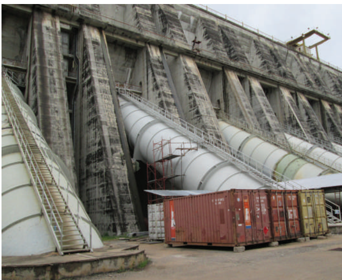
Inga 1 e Inga 2, construídas em 1972 e 1982 respectivamente, estão em estado degradado e não podem satisfazer as necessidades de energia da RDC.
